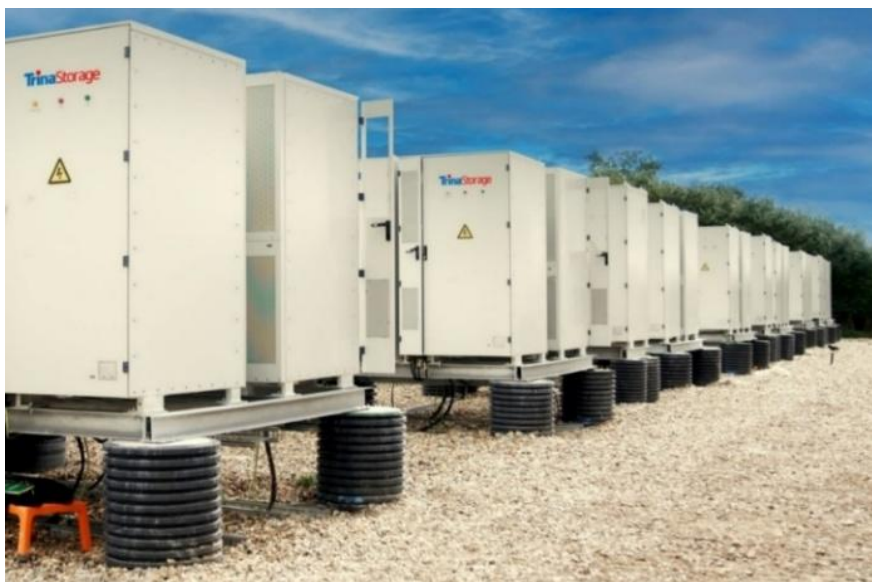
1.7.1. attēls. BESS konteineri tuvplānā (ilustratīvs attēls, autors: Kristīne Eglīte)
