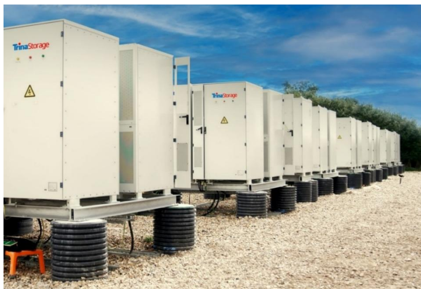
4.4.1. attēls. BESS konteineri tuvplānā (ilustratīvs attēls, autors: Kristīne Eglīte)
